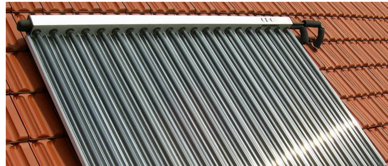
Die Eignung des Daches sollte für die Installation einer Solarthermie-Anlage geprüft werden, einschließlich Ausrichtung, Neigung und möglicher Schattenwürfe, um die bestmögliche Leistung zu erzielen. Auch lokale Baubestimmungen und Genehmigungen müssen beachtet werden © Eberhard Rudert, stock.adobe.com
