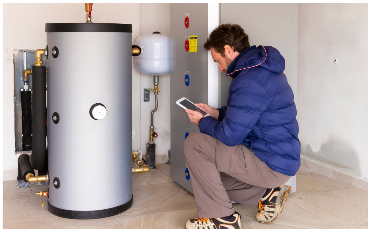
Durch die Messung des Verbrauchs kann der Klempner feststellen, ob der Heizkessel ordnungsgemäß gewartet wird. Ein ungewöhnlich hoher Verbrauch könnte auf Verschleiß oder andere Probleme hinweisen, die eine Wartung erfordern © caifas, stock.adobe.com
