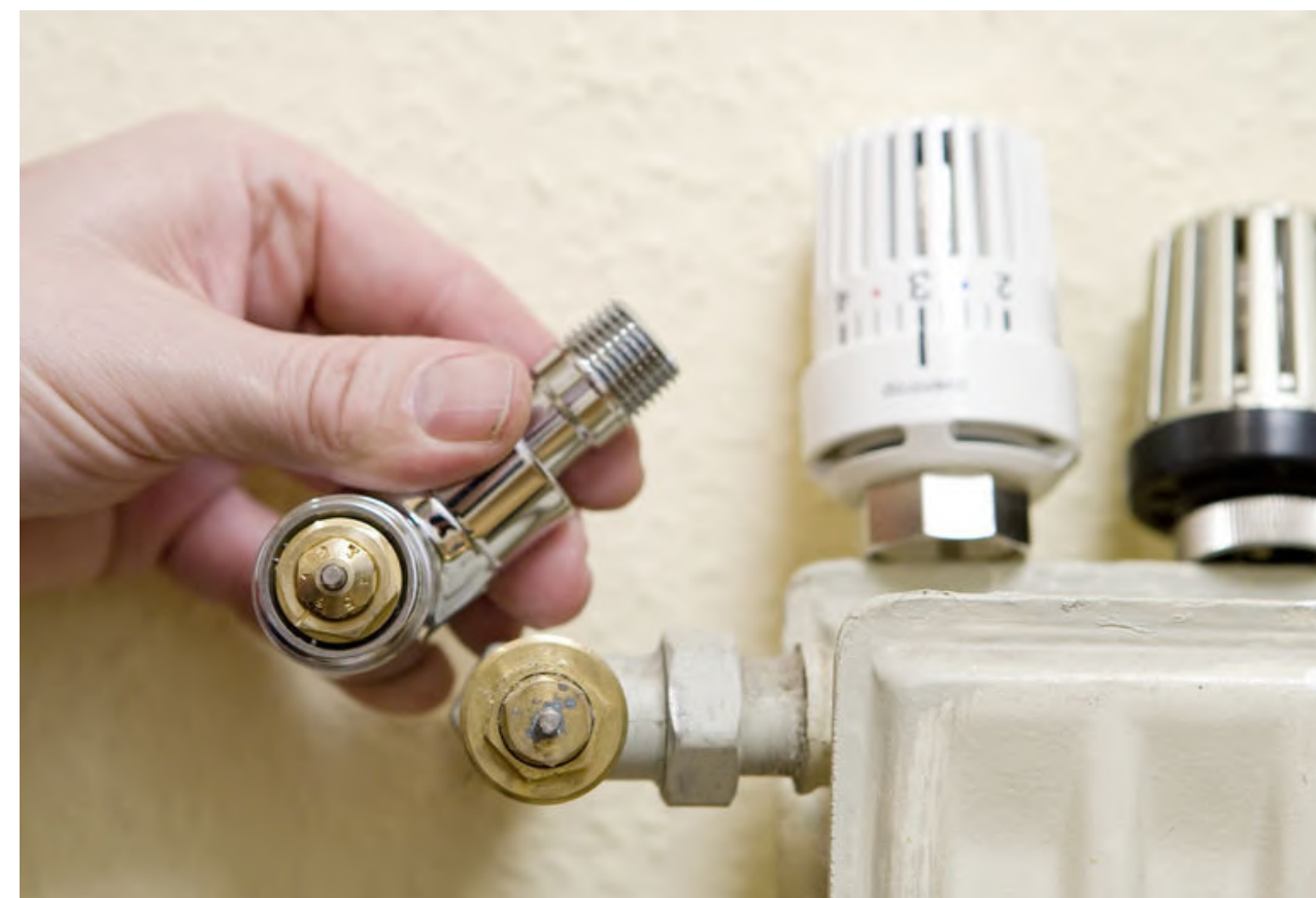
Die Voreinstellventile an den Heizkörpern steuern die Durchflussmenge des Heizwassers. Passen Sie diese Ventile basierend auf den Berechnungen und der Heizlast an © ZVSHK, stock.adobe.com
