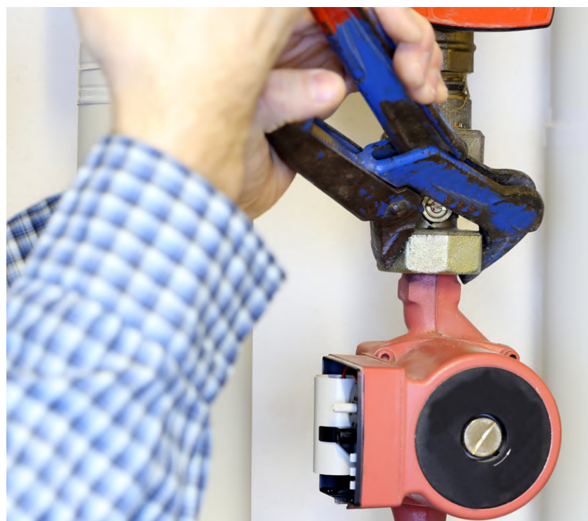
Beim Austausch der Heizungspumpe wird die Heizungsanlage ausgeschaltet, um sicherzustellen, dass während der Arbeit keine Wärme erzeugt wird und das Wasser im System abgekühlt ist © rupbilder, stock.adobe.com
